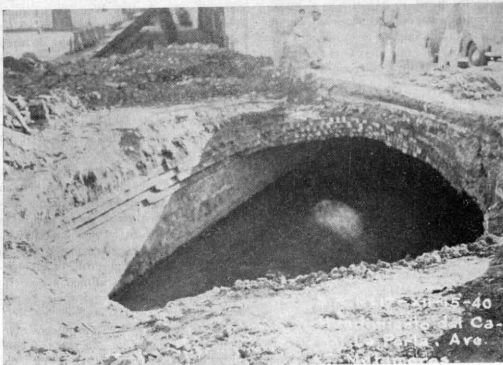
Distrito de Riego de la Región Lagunera.—Vista de la bóveda del túnel de La Perla que cruza la ciudad de Torreón y que recientemente se ha hundido en algunos sitios, por pulverización del ladrillo.
