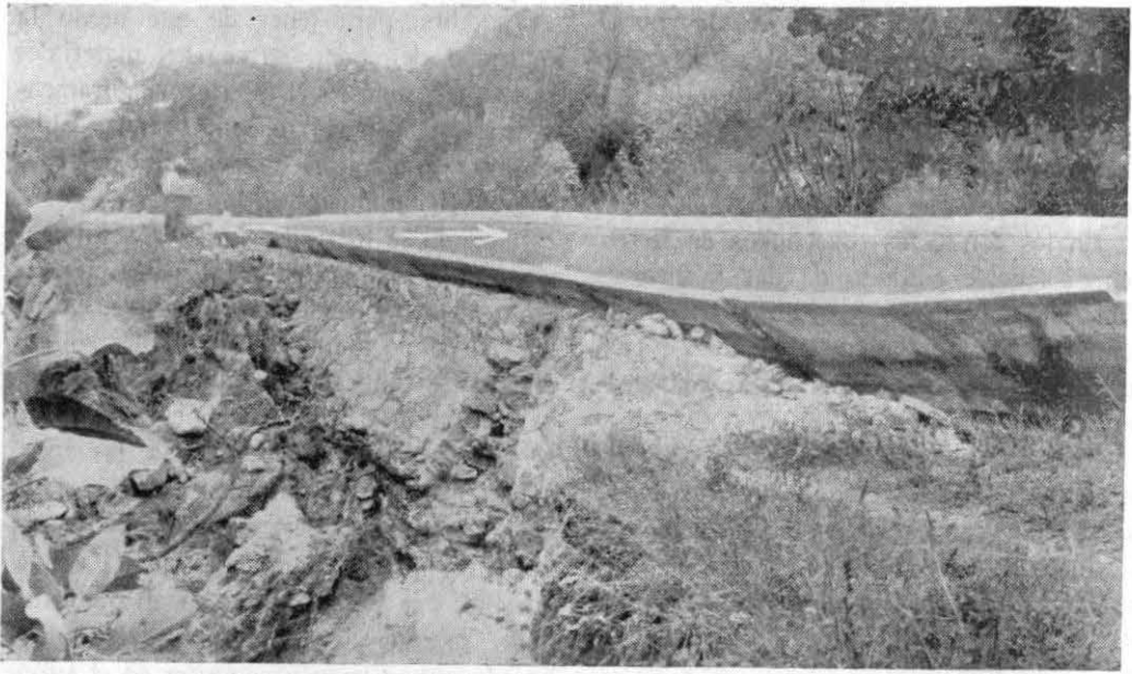
Distrito de Riego de Tula, Hgo.—Rotura del revestimiento del concreto por derrumbe del borde de apoyo.
