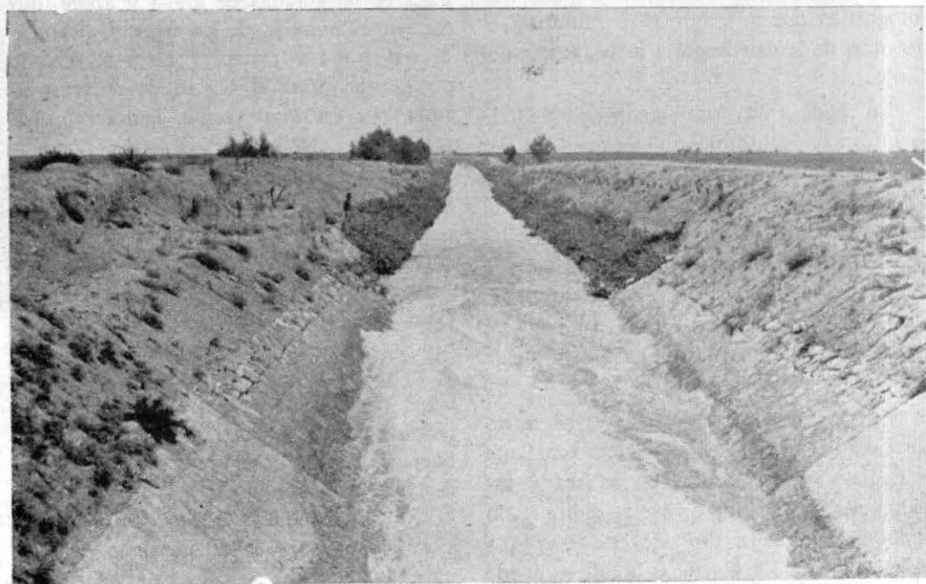
Distrito de Riego de Don Martín, Coab. y N. L. Lateral Sur Camarón.—Protección adecuada, estableciendo transición entre concreto y el terreno, pasando a zampeado y enramada.
