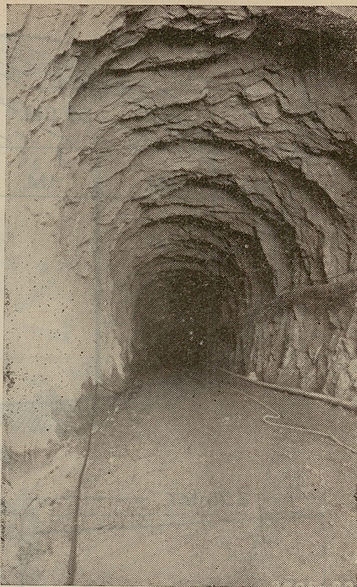
Vista tomada a 30 metros de la entrada hacia adentro. A la derecha se observa en la parte inferior la tubería de aire comprimido de 3" y en la parte media la tubería de ventilación de 12". Para el agua se utilizó tubería de 2".
